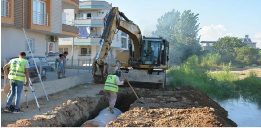
MESKİ TARSUS UN MERKEZİNDE AÇIKTAN AKAN KANALI KAPATTI
